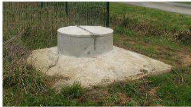
Figure 10 : Tête de forage avec dalle de protection en béton et capot étanche
